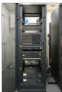
3本使用していたサーバラックが1本になりました。
